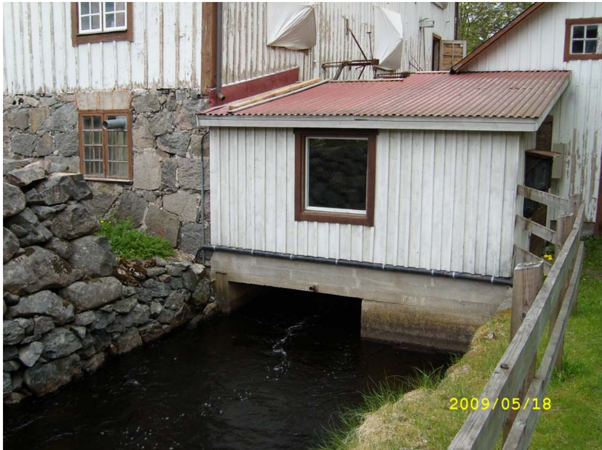
Figur 15. Avloppskanalen efter det att vattnet lämnat turbinsumpen.
